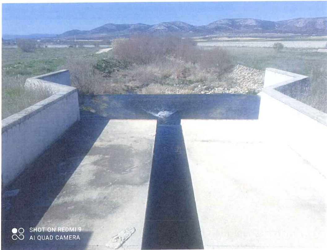
Foto 5: Cauce del río Cigüela a su paso por la CR-1341 de Herencia a Cinco Casas aguas abajo
